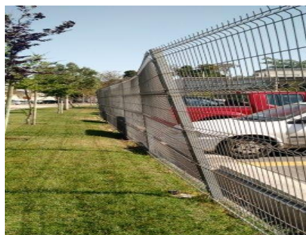
Pérdida verticalidad en reja perimetral.
