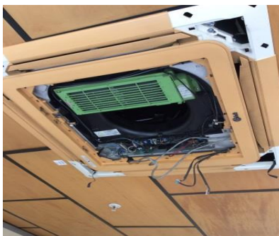
Mantenimiento de equipo de Climatización con problemas en Sistema de desagüe.
